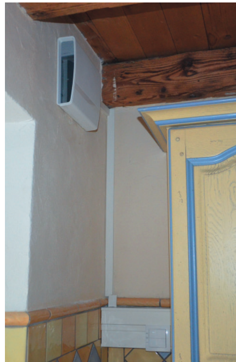
L'indispensable système de ventilation pour assurer le renouvellement d'air.
