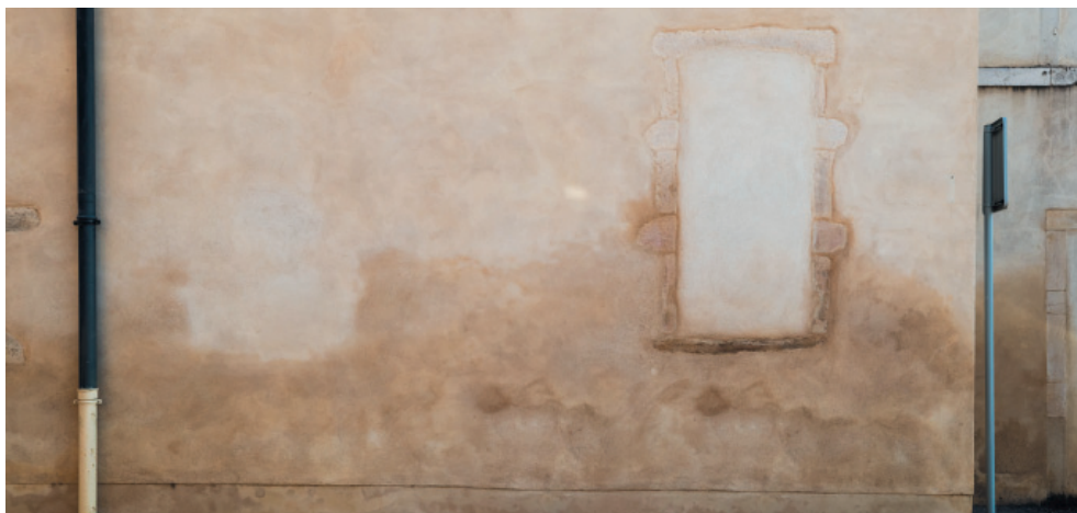
Remontées d'humidité dans un mur : à traiter en priorité.
