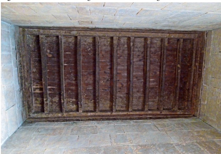
Fig. 36. Plafond du corridor A1.
